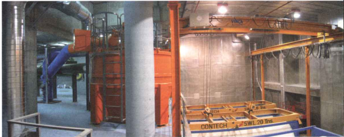
Vista panorámica del interior de la central
