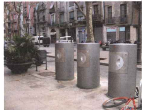
Buzones de recogida neumática de residuos sólidos
